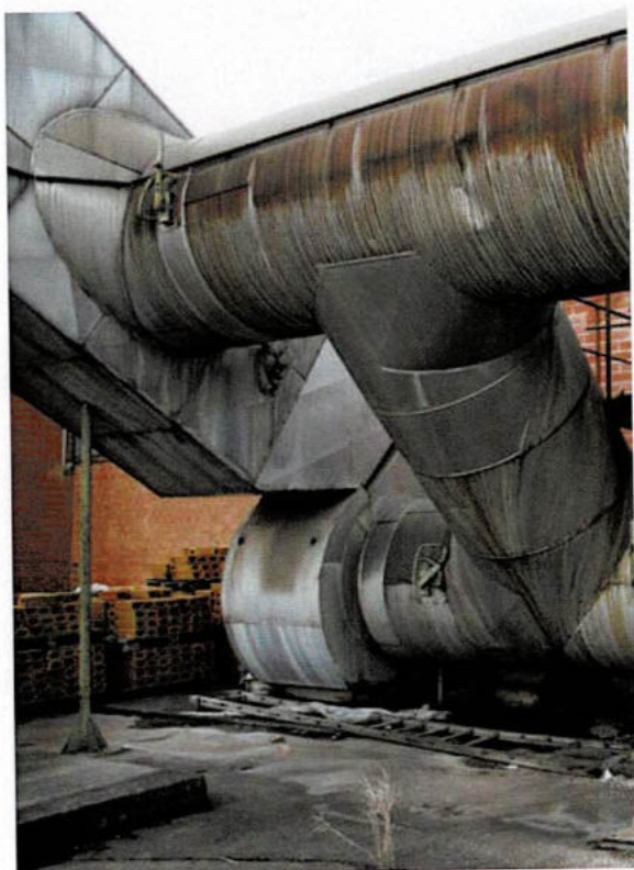
Rauchgasreinigungsanlage (28, siehe Seite 3)
