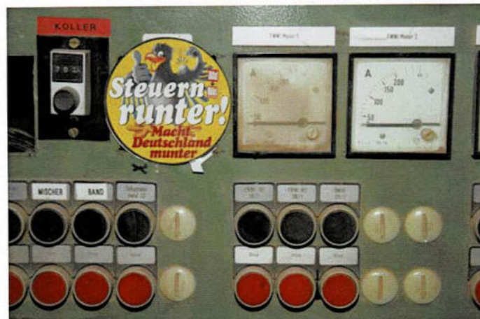
Steuerpult Kollergang Aufbereitung
