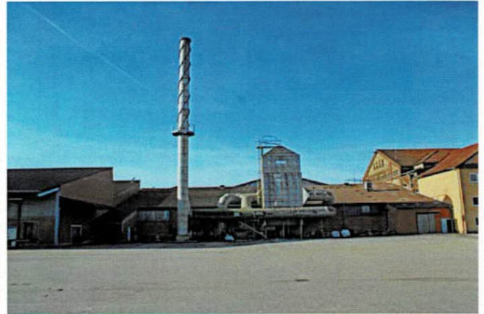
Rauchgasreinigungsanlage (28, siehe Seite 3)
