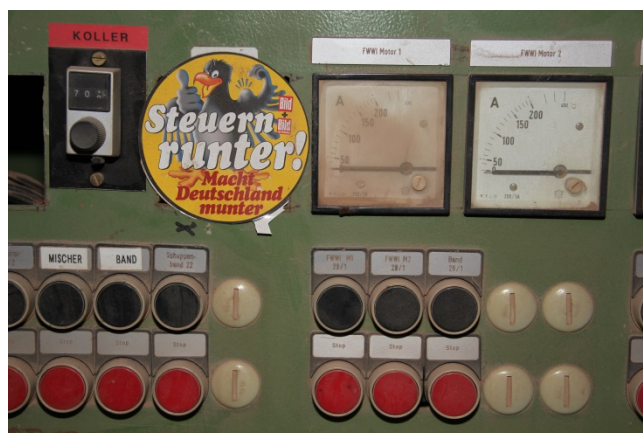
Steuerpult Kollergang Aufbereitung (7)
