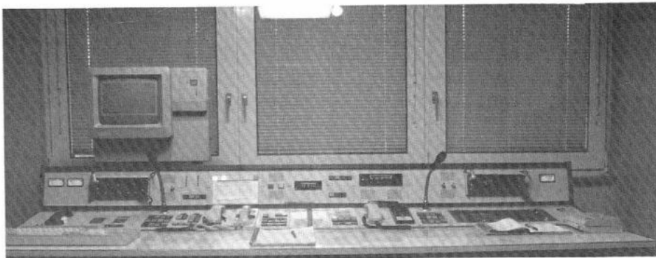
Mehr als eine Telefonzentrale: Funk, Funkalarmierung, Anzeigetafel, Feuermelder, Computer.
