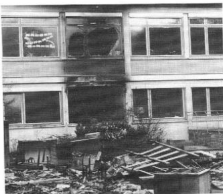
Brand in der Grundschule Lienzingen
